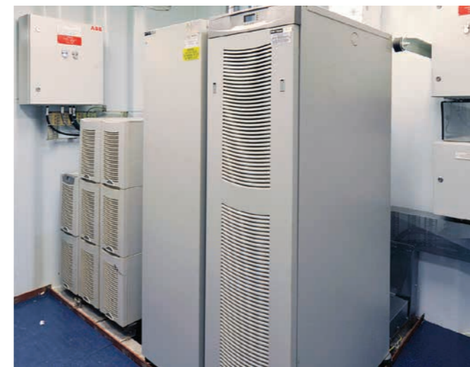
在“海洋绿洲号”上，伊顿船用型 UPS 为关键应用负载提供安全电力保护，使其免受断电影响
